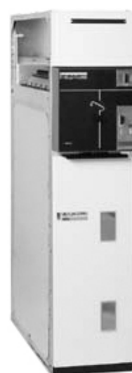
Fig. 16 : Cellule de disjoncteur MT (SM6 - Merlin Gerin).
